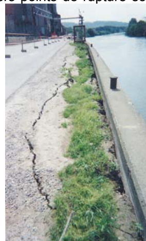
Dégradation d'une protection en génie civil
